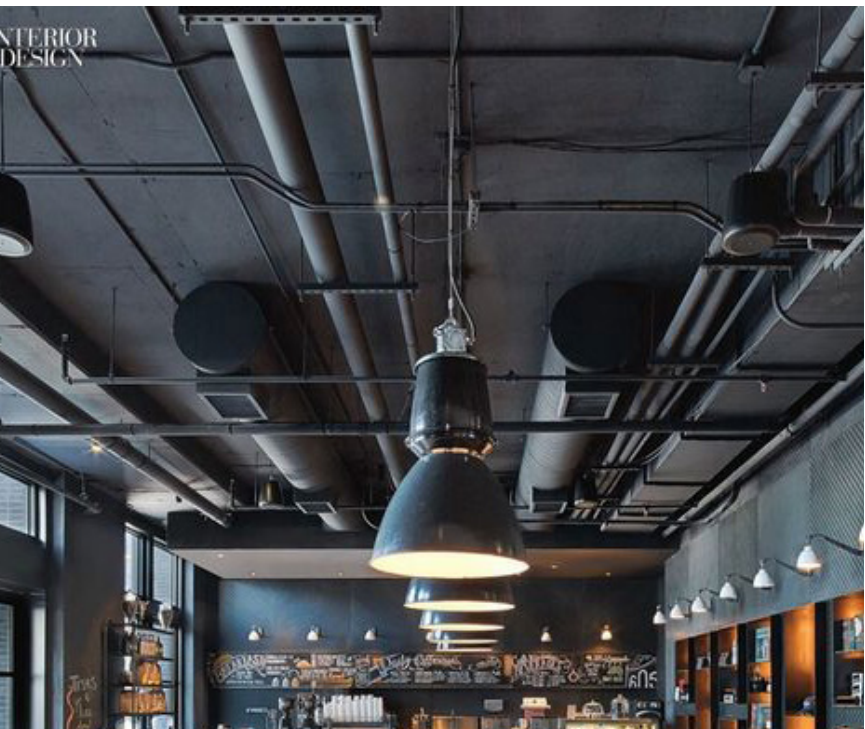
Installatie zoveel mogelijk in het zicht laten, ivm onderhoud en vervanging
