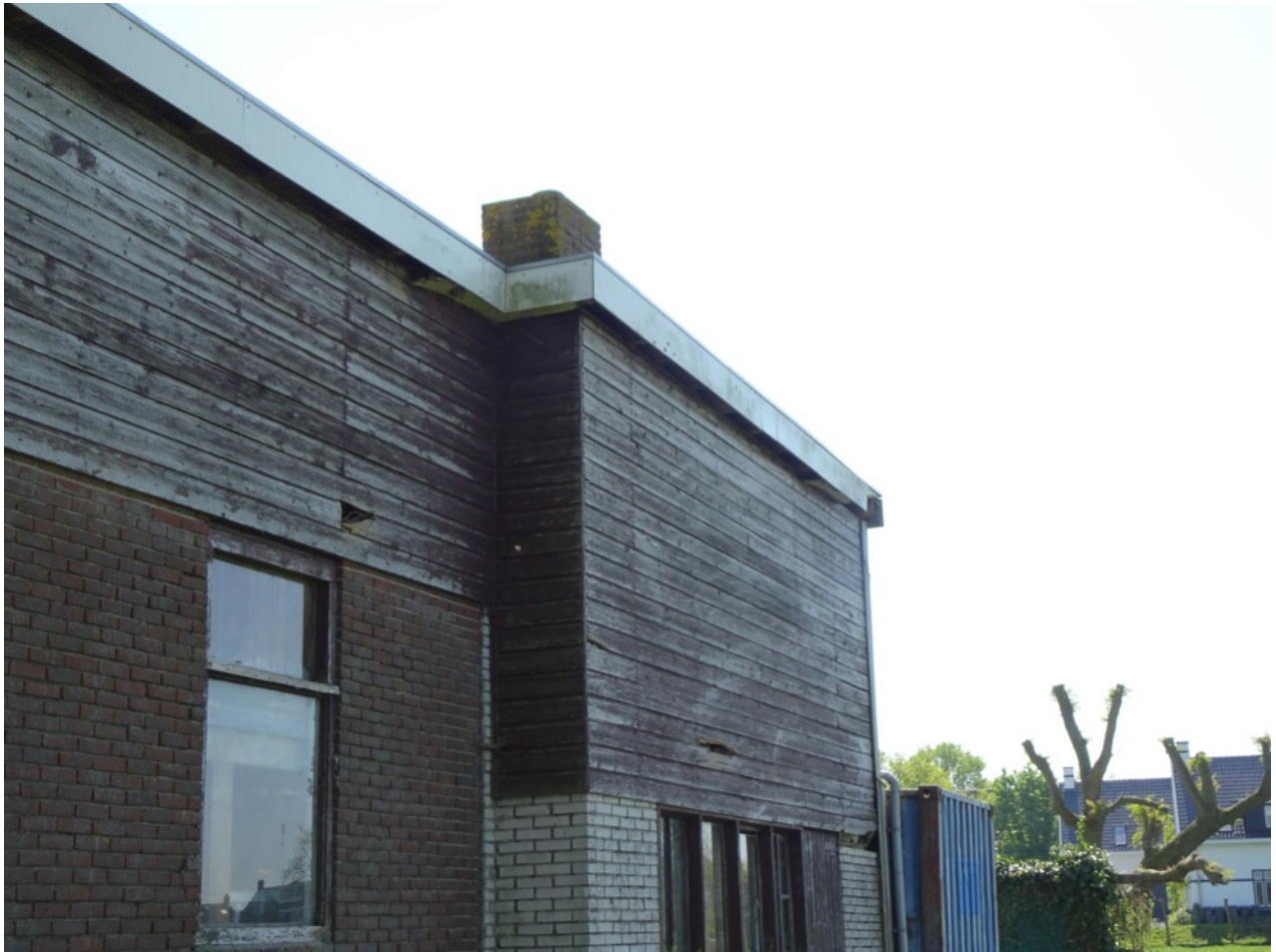
Westelijke gevel met gaten waarachter nesten Kauw en gaten bij overstekend dak
