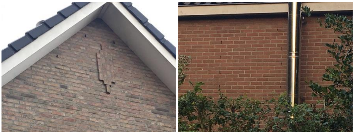
Open stootvoegen in de buitengevels van beide woningen. Alle gebouwen in het plangebied worden beschouwd als een potentiële verblijfplaats voor vleermuizen.
