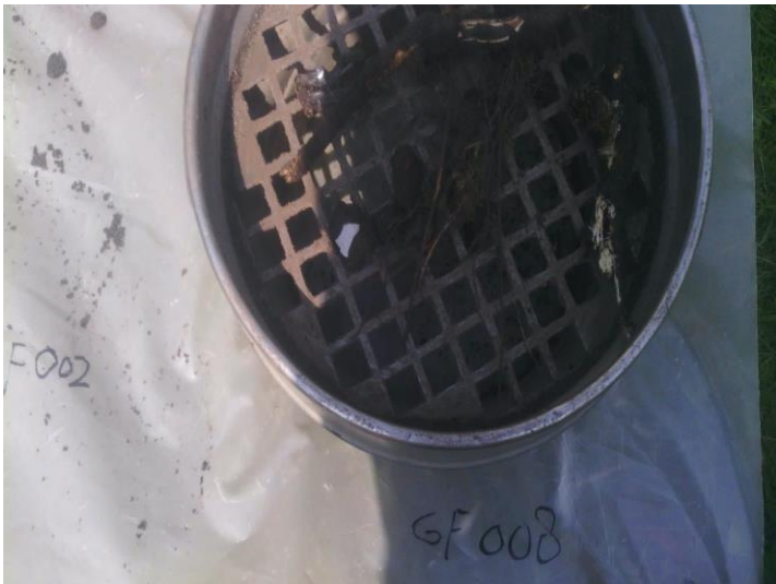
Fotonummer: 23 Omschrijving: Gat 008
