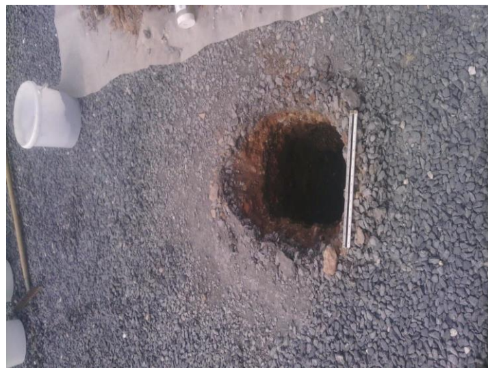
Fotonummer: 10 Omschrijving: Gat 004
